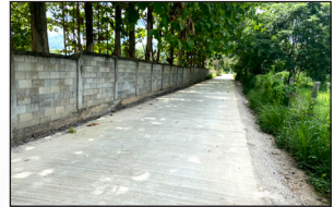
โครงการก่อสร้างถนนคอนกรีตเสริมเหล็ก ภายในหมู่บ้าน ขอย 2, 5 หมู่ 1
