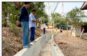
โครงการก่อสร้างรางระบายน้ำ (ค.ส.) และวางท่อพร้อมบ่อพัก ค.ส.ล หมู่ 12 บ้านหัวทุ่ง
