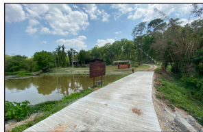
โครงการก่อสร้างถนนคอนกรีตเสริมเหล็ก ภายในหมู่บ้าน ขอย 4 , 9, 10 หมู่ 10
