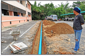
โครงการปรับปรุงน้ำเสีย เทศบาลตำบลแม่กา
