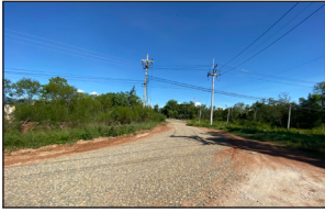
โครงการก่อสร้างซ่อมแซมถนนหินคลุก ขอยข้าง มจร.(ฝั่งทิศตะวันออก) หมู่ 2
